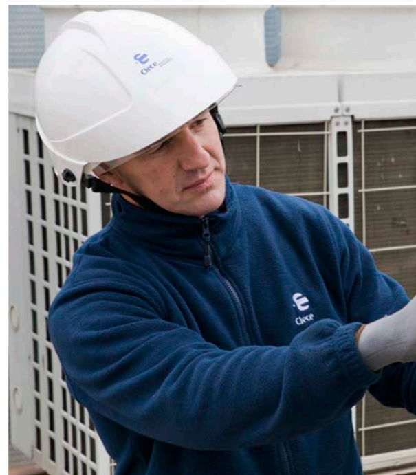
Arriba, a la derecha, trabajos de mantenimiento del Centro de Procesamiento de Datos del Ministerio de Justicia. Sobre estas líneas, Clece prestando el servicio en la sede de Endesa en Sevilla.
